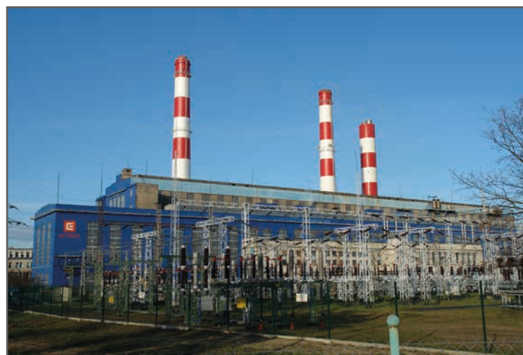
Elektrownia CEZ Skawina S.A.
